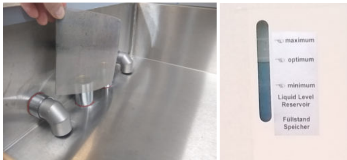
Abbildung 8: Einsetzen des Filters (links) und optimale Füllmenge der Wärmeträgerflüssigkeit in der Anlage (rechts).
