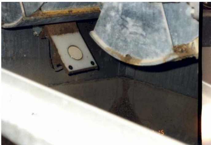
Sondereinbau auf einer Rutsche unterhalb des Siloverschlusses
